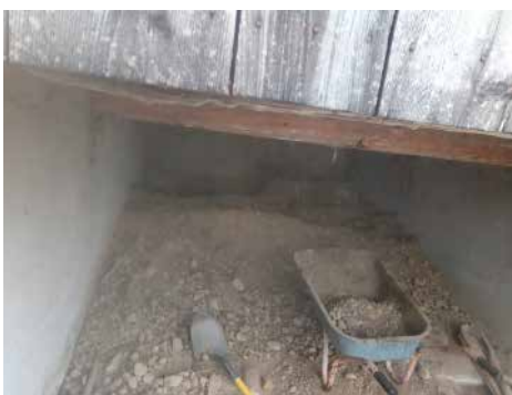
Vorher; der Dachs hat die Garage beinahe zugeschüttet.
